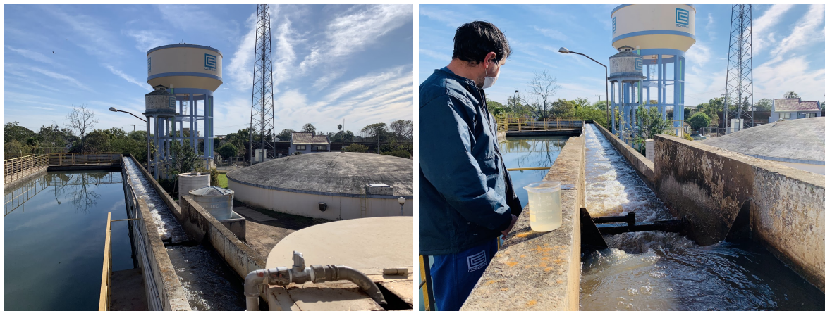
Figura 16: ETA. Calha de realização do processo de Mistura Rápida
